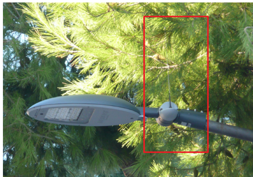
06 Particolare del sistema d'antenna su apparecchio LED Meridio con ripetitore RLU 169MHz
