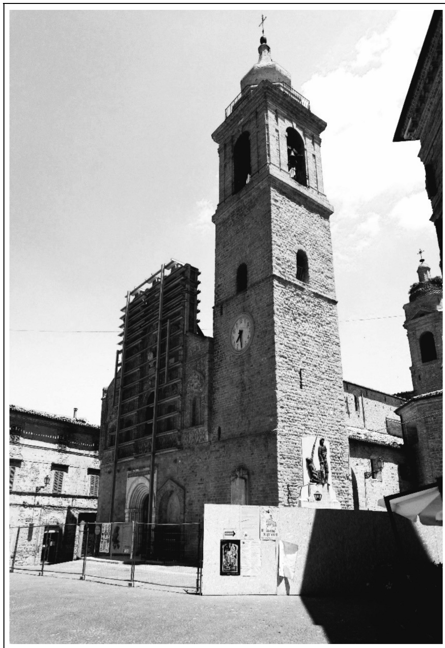
Figura 7 – Collegiata di San Ginesio: danneggiamenti a seguito del sisma e opere preventive di messa in sicurezza.
