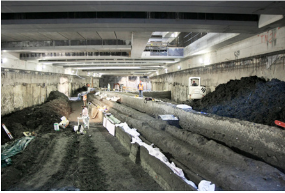
Fig. 2. Scavi archeologici in corso nel cantiere per la realizzazione della stazione S. Giovanni - Metro C, Roma (foto @MetroC).
