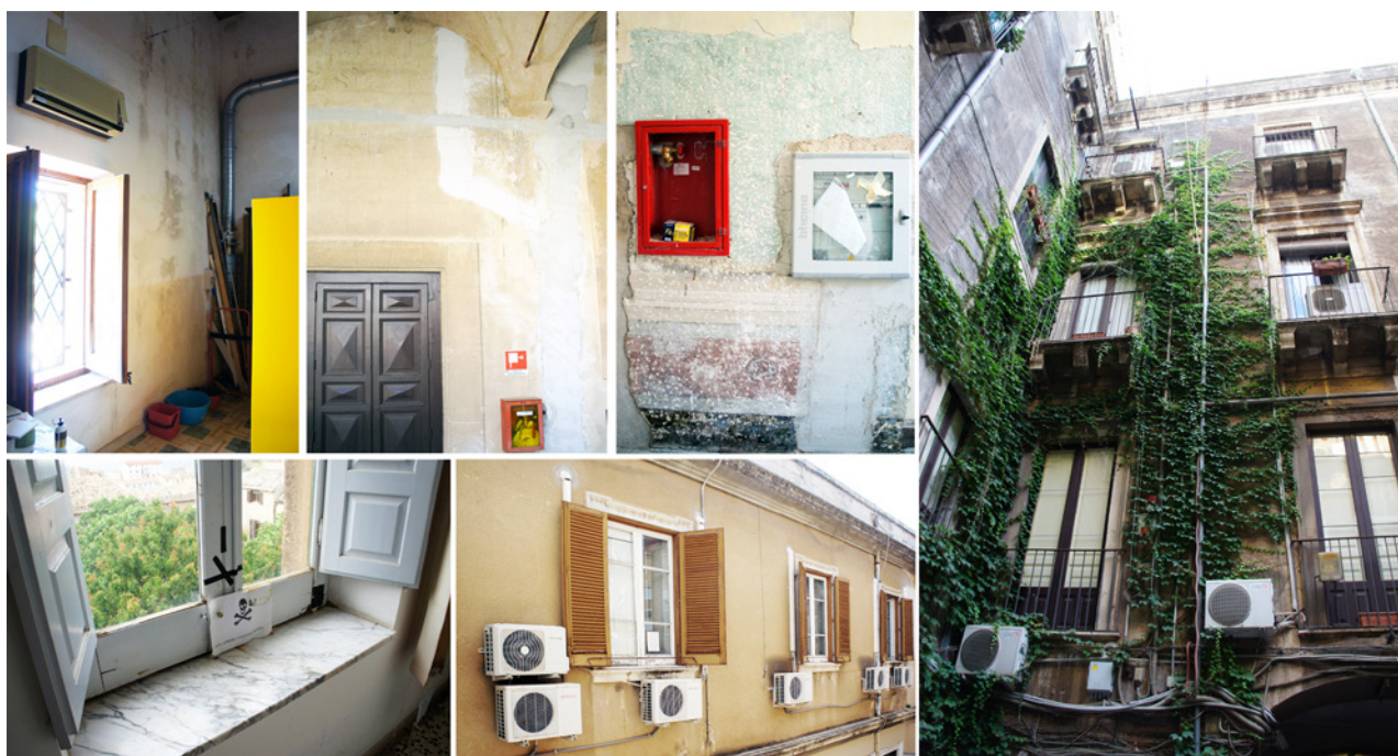
Fig. 4. Esempi di interventi non programmati e di mancanza di manutenzione (Foto Buda 2018).
