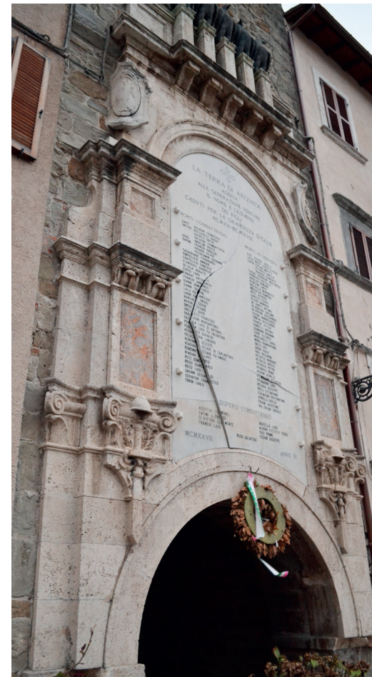
fig. 8 Particolare dei danni causati al Monumento dopo le scosse di terremoto di agosto 2016
