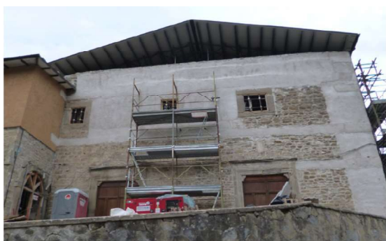
Fig. 9. Opere provvisorie nella chiesa di S. Francesco a Borgo di Arquata.
