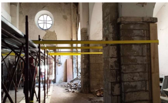
Fig. 10. La chiesa di Santa Maia Vetere a Pretare messa in sicurezza solo parzialmente.
